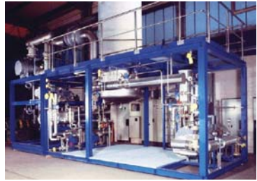
Pervaporationsanlage: Membran-High-Tech von der Firma Sulzer
