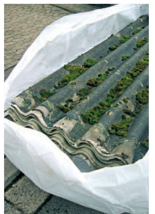
Vorsicht: Alte Eternitplatten sind asbesthaltig!
