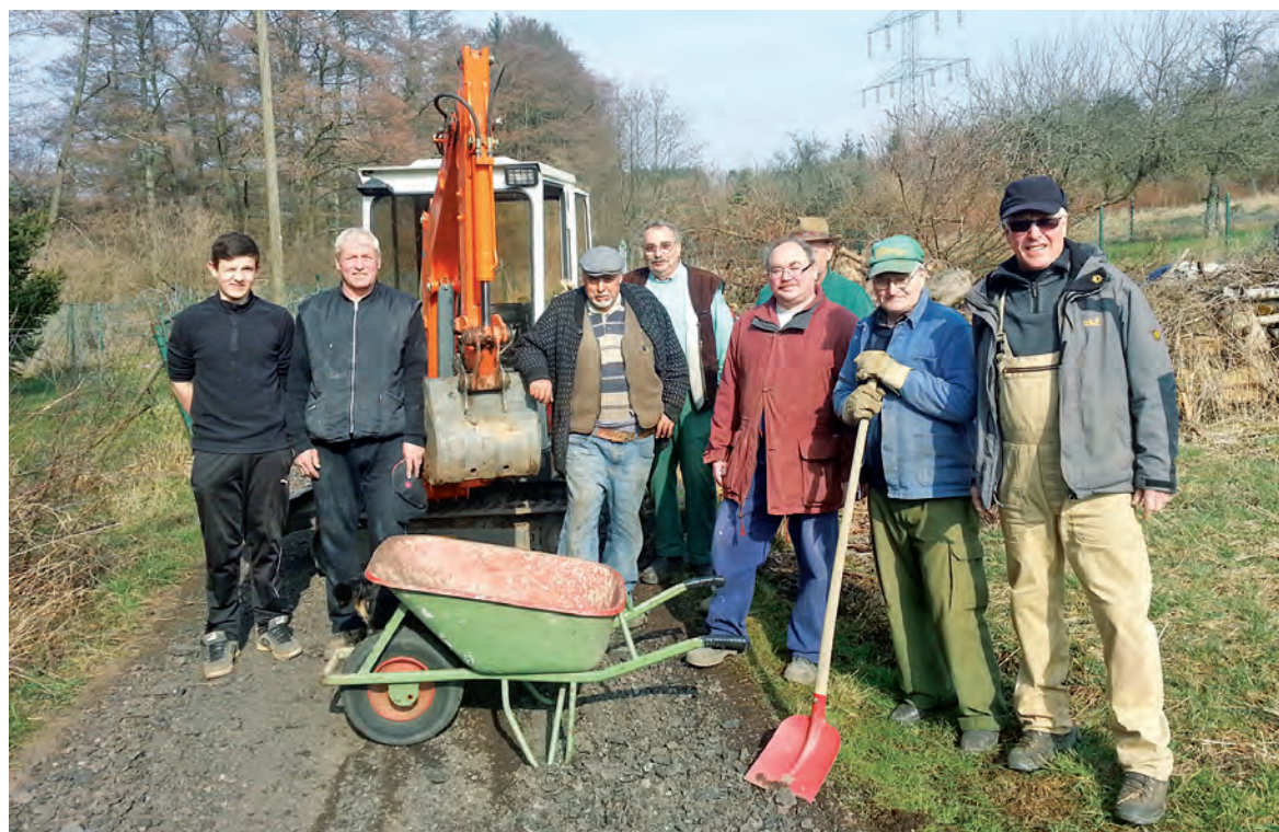
Zuwegung zum Brunnenpfad in der Verlängerung der Richard Wagner Straße wieder in Ordnung Foto: Stadt Nk
